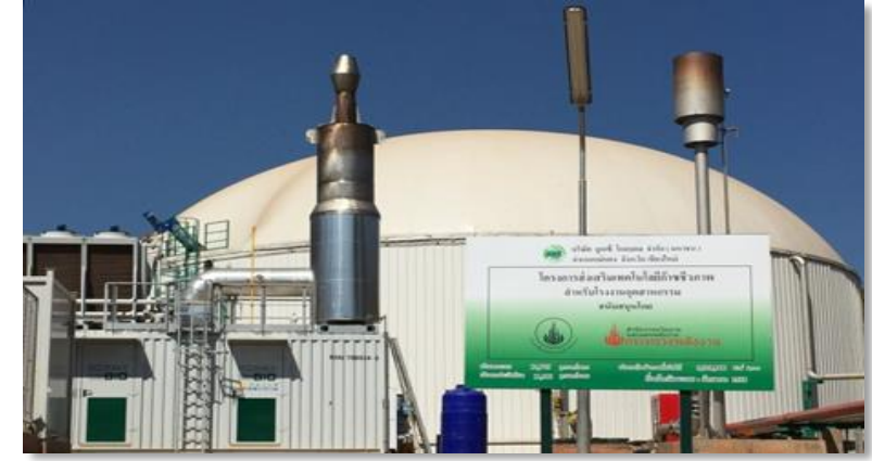
โรงงานผลิตไฟฟ้าจากก๊าซชีวภาพ แม่แตง เชียงใหม่
